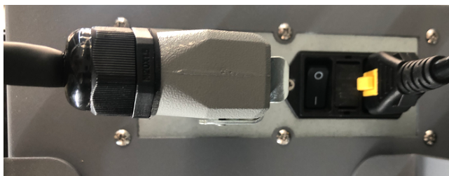
图 5-4: 机器人线缆与控制箱的连接
