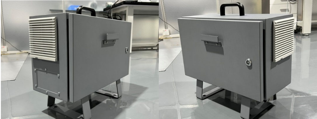
图 2-2 控制柜过滤器位置
