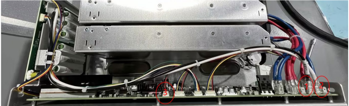
图 3-28 Safe IO 上的线缆位置
